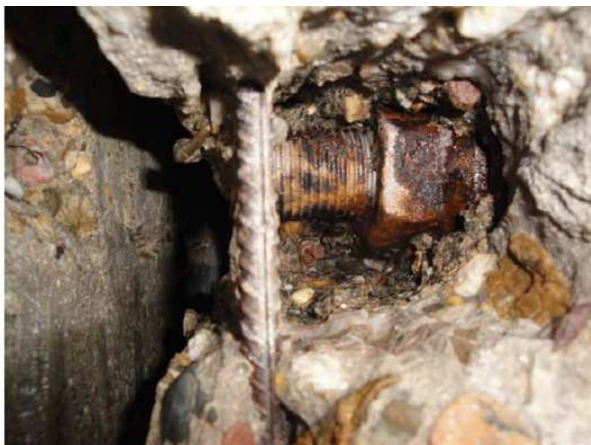
Bild 2 Oberflächige Korrosion im Bereich der Spannköpfe
