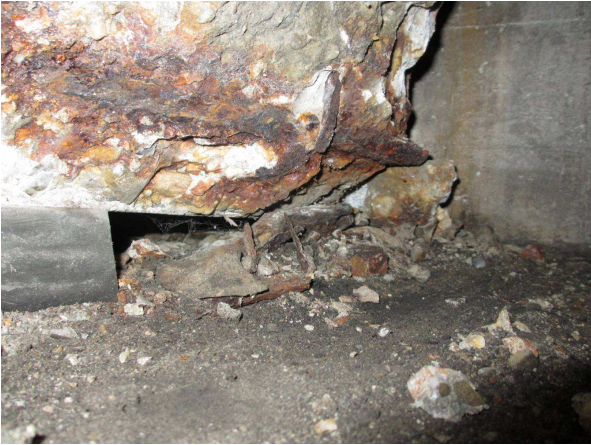
Bild 1 Chloridinduzierte Korrosion im Bereich der Bügel- und Längsbewehrung
