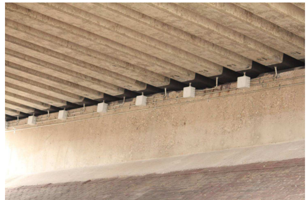
Bild 6 KKS-System nach der Ausführung mit Monitoring Einheiten für jeweils 3 Längsträger
